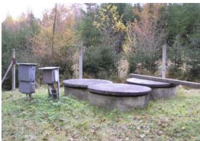
Soustava studní pro vodovod Chmelná
