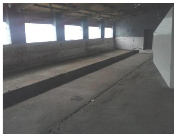
Obr. 16: Hala F kompletně zbavená odpadů
