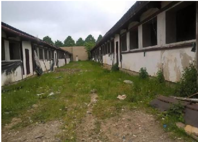
Obr. 27: Meziprostor D-E po odstranění odpadů
