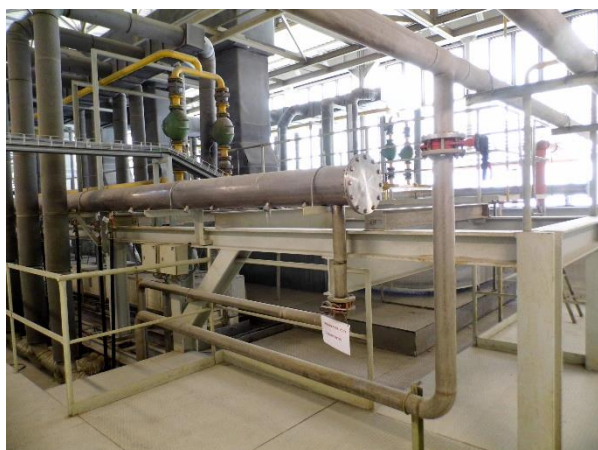
Nerezové rozvody v tažárně
