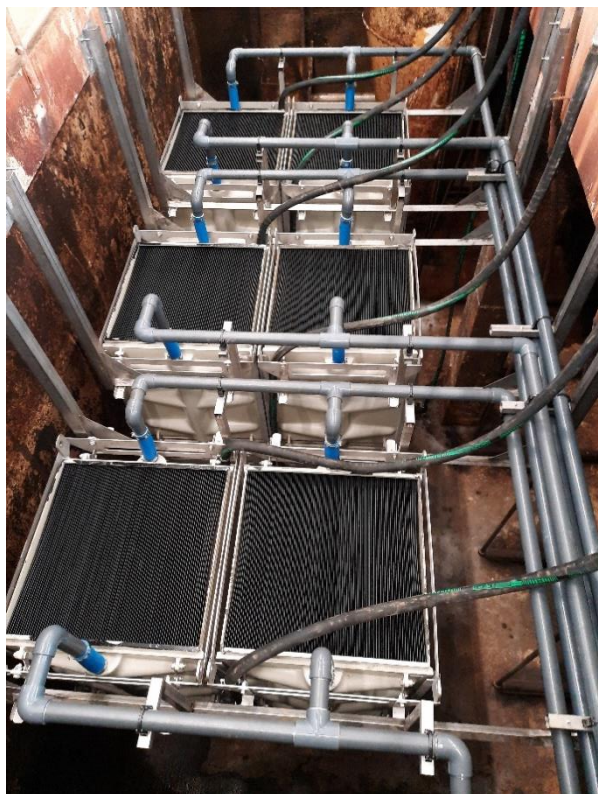
Instalované MBR moduly
