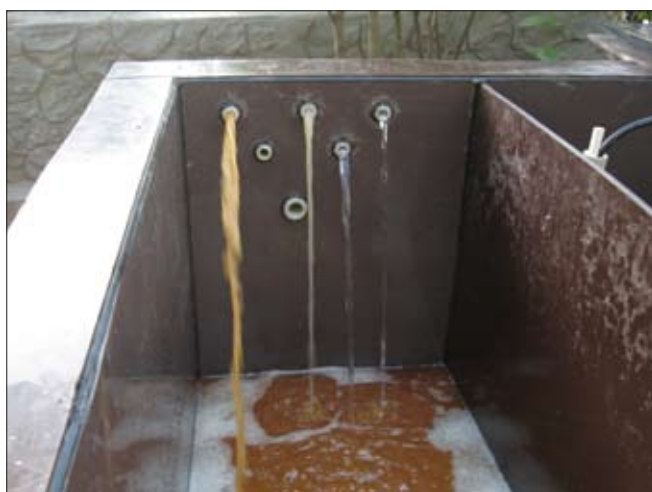
Obr. 14: Přívod kontaminované podzemní vody ze sanačních vrtů do přečerpávací jímky na ul. Sfintul Dimitru
